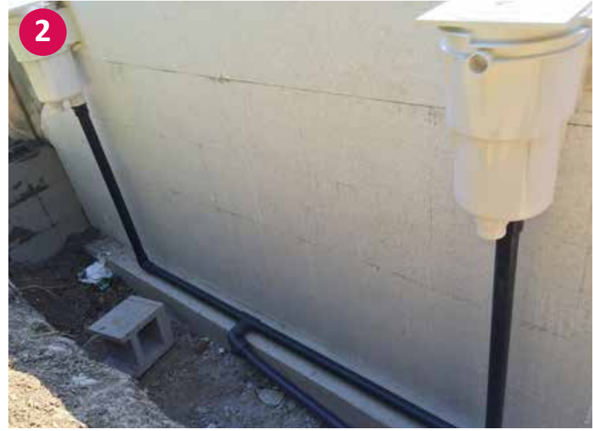
▲ Verrohrung von 2 Skimmer
