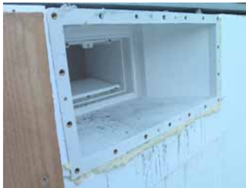
▲ Fertig eingeschäumte WH-Skimmer
