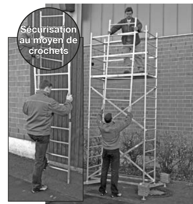
Echafaudage de base avec première et deuxième rehausses
